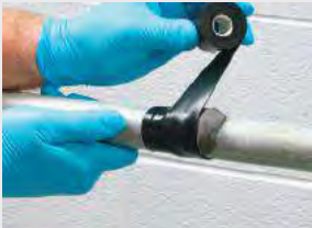
1. 기본 패치(퍼티&압박테이프)를 손상된 부위에 돌려주세요.
